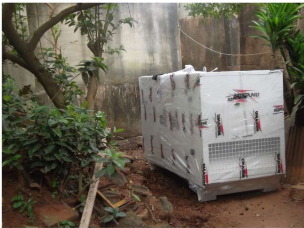
Hier nog ingepakt, nu draait de generator.
